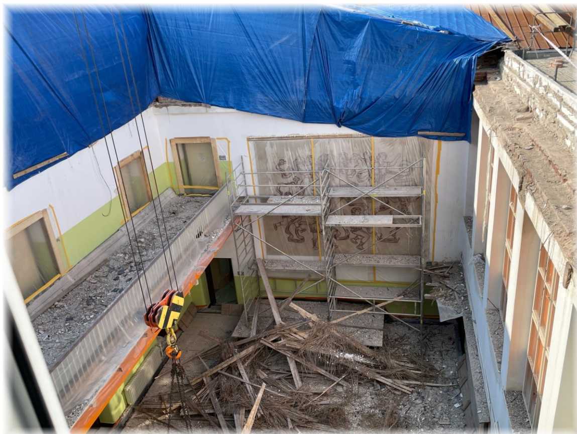
První fáze započaté přístavby školy – stržení stropu v hale a nahrazení nosným.
